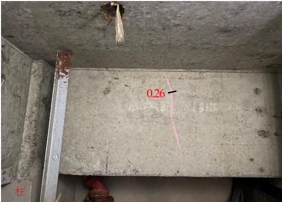
图 5.3-4 I×30~29 轴间框架梁左端的裂缝
