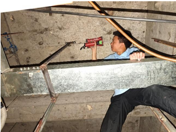
图 5.7 板底钢筋扫描检测
