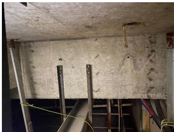
图 5.3-3 30×K~I 轴间右段梁裂缝
